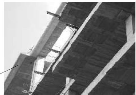
Anclaje de andamio colgante
